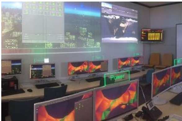
Abb. 2 Kontrollraum für den Betrieb
